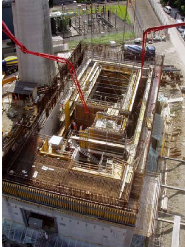
Äusserst massive Bewehrung gegen Flugzeugabstürze Massively reinforced concrete walls prevent damage from a possible plane crash
