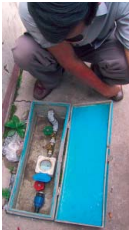
Überwachung Wasserzähler in Nam Dinh Controlling a residential water meter in Nam Dinh
