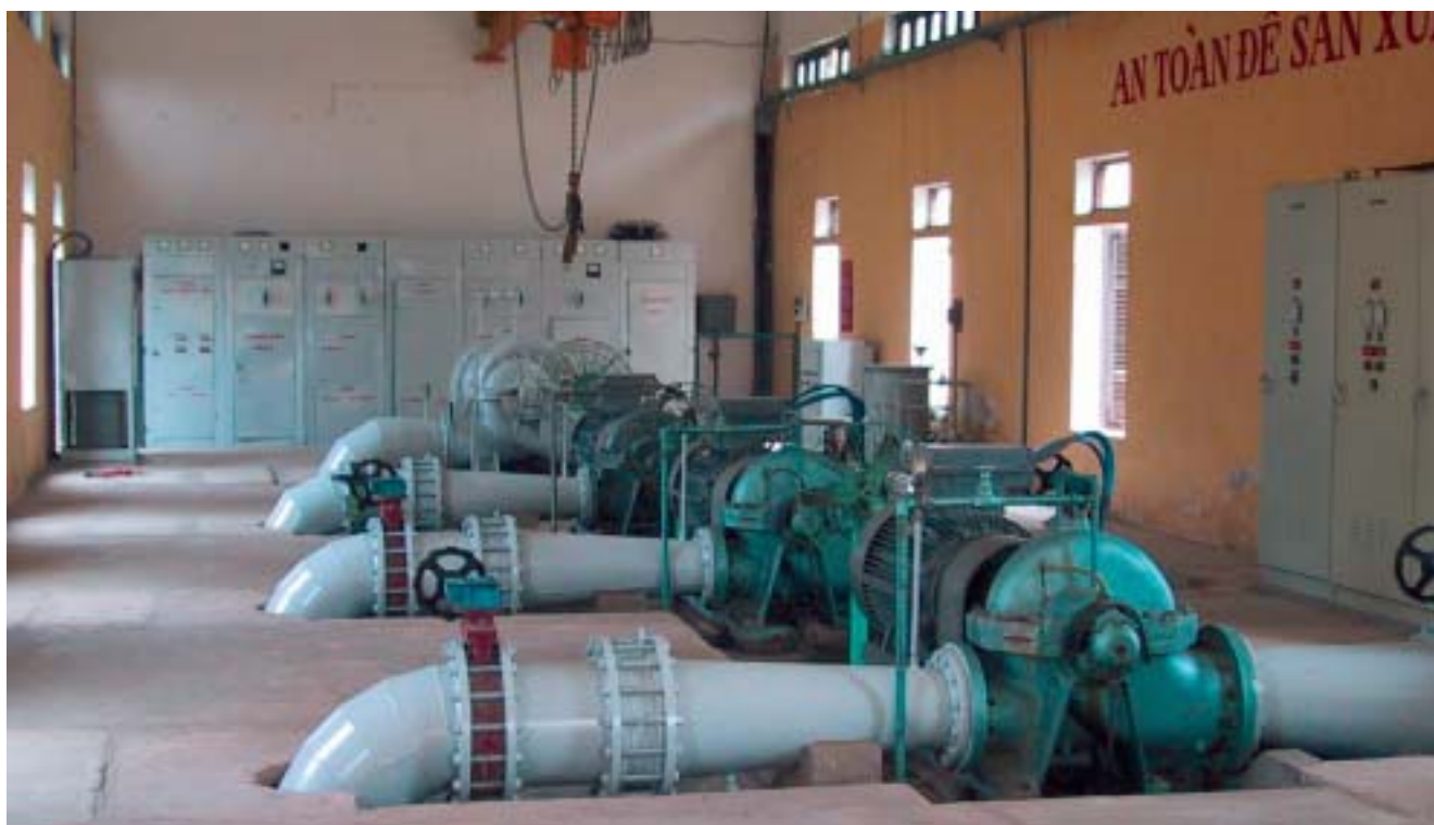
Pumpstation der Wasserwerke Nam Dinh
