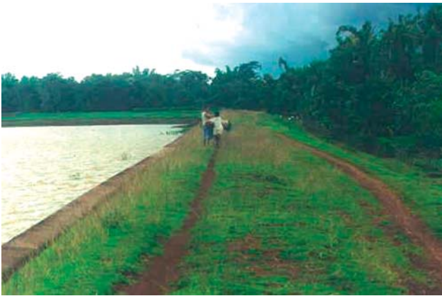
Bild 1: Der Delingan Damm vor der Sanierung Picture 1: Delingan Dam before rehabilitation
