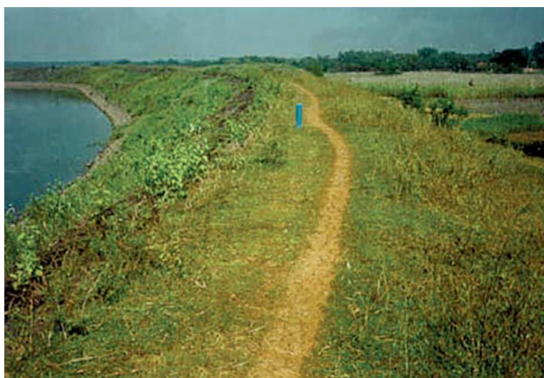
Bild 5: Der Lalung Damm vor der Sanierung Picture 5: Lalung Dam before rehabilitation
