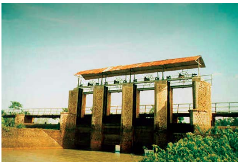
Bild 3: Delingan Hochwasserentlastung vor der Sanierung Picture 3: Delingan Spillway before rehabilitation
