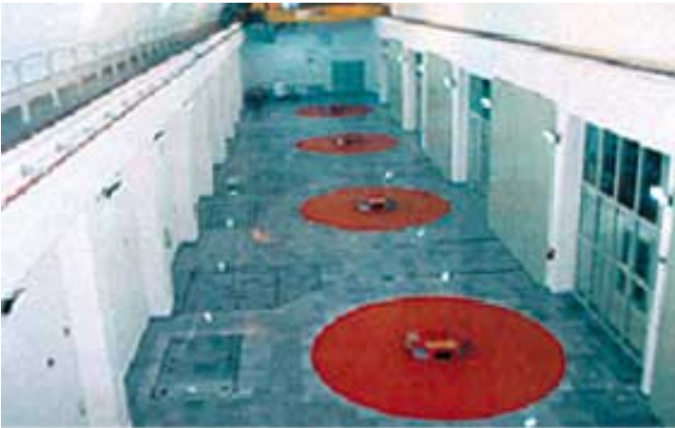
Wasserkraftwerk Singkarak - unterirdisches Maschinenhaus Singkarak Hydropower Plant - Underground Machine Hall
