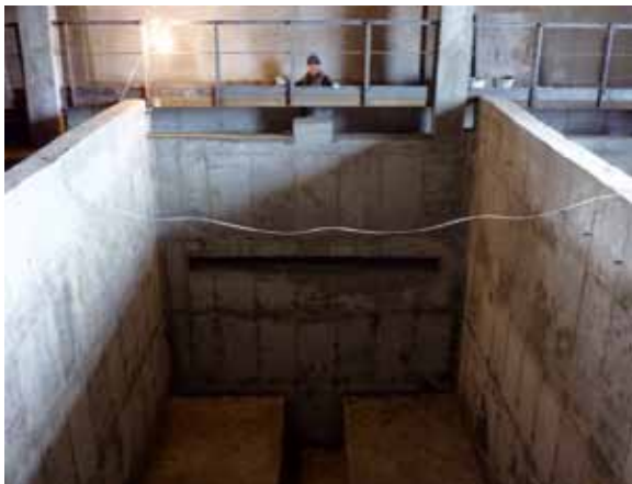
1 von 3 Filterkammern innerhalb der Aufbereitungsanlage (ohne Filtermedium und hydro-mechanische Ausrüstung), März 2010 (links)
